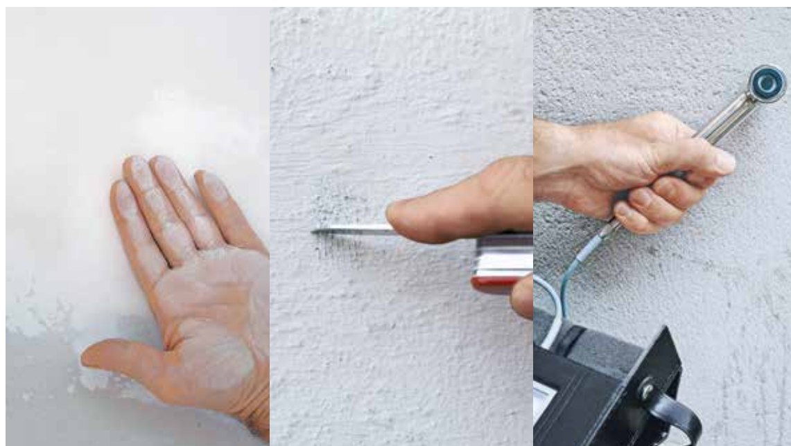
Bilde til venstre: Se etter krittende overflater
